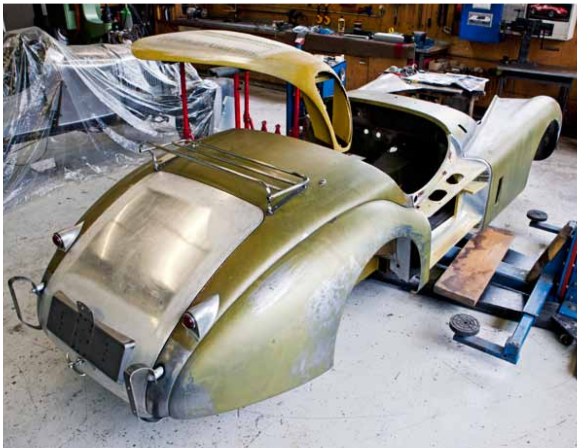
Die Substanz der Stahlkarosserie ist noch sehr gut. Grüner Washprimer verhindert Rostbefall während der Restaurierung. Die gesamte Technik wurde zur Überholung ausgebaut.
